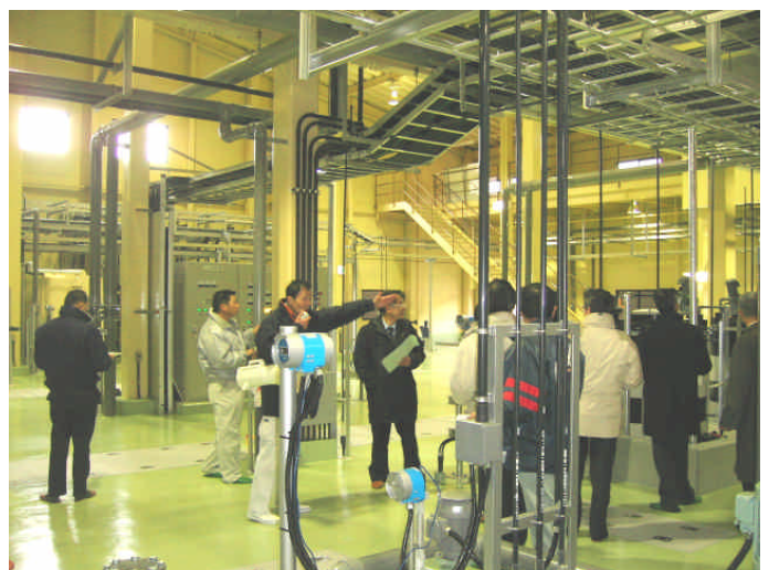
浸出水処理施設
