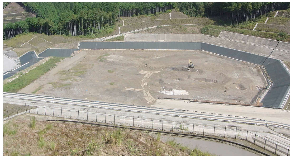
2010年10月1日現在 クリーンセンター滋賀埋立状況
